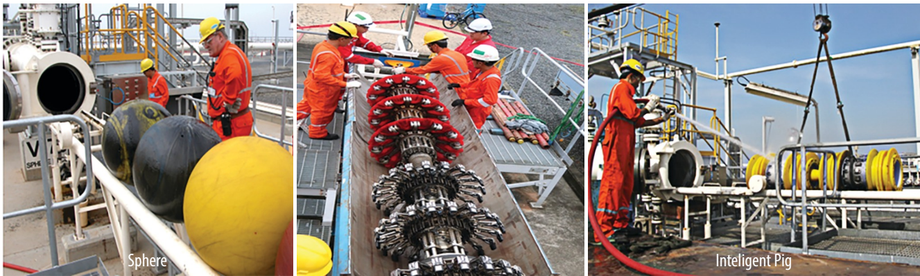
Hình 11. Hình ảnh nhận thoi tại Nhà máy xử lý khí Nam Côn Sơn.
